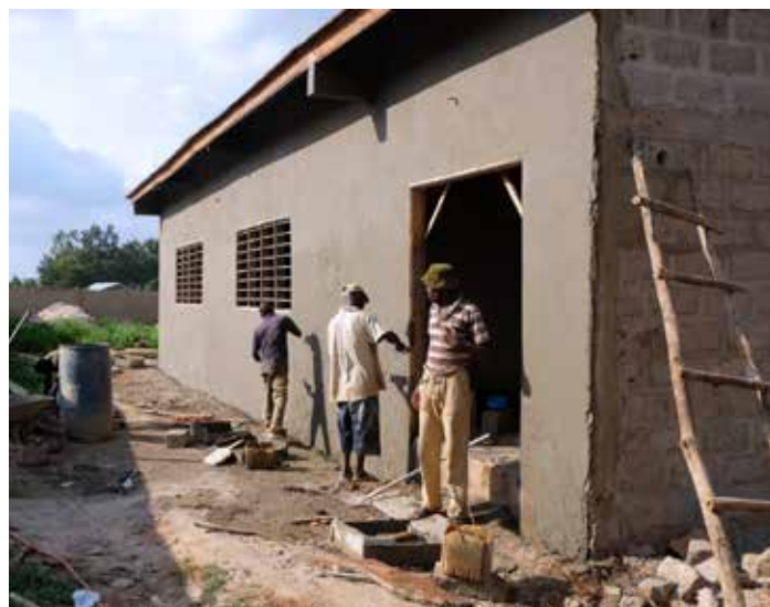
Noch befindet sich das Gebäude im Bau – bald können hier die Auszubildenden schlafen.
