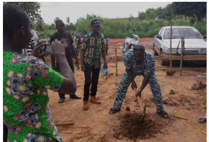
Der erste Spatenstich am 24. September 2016. Bezogen wurde das neue Gebäude noch vor Jahreswechsel.
